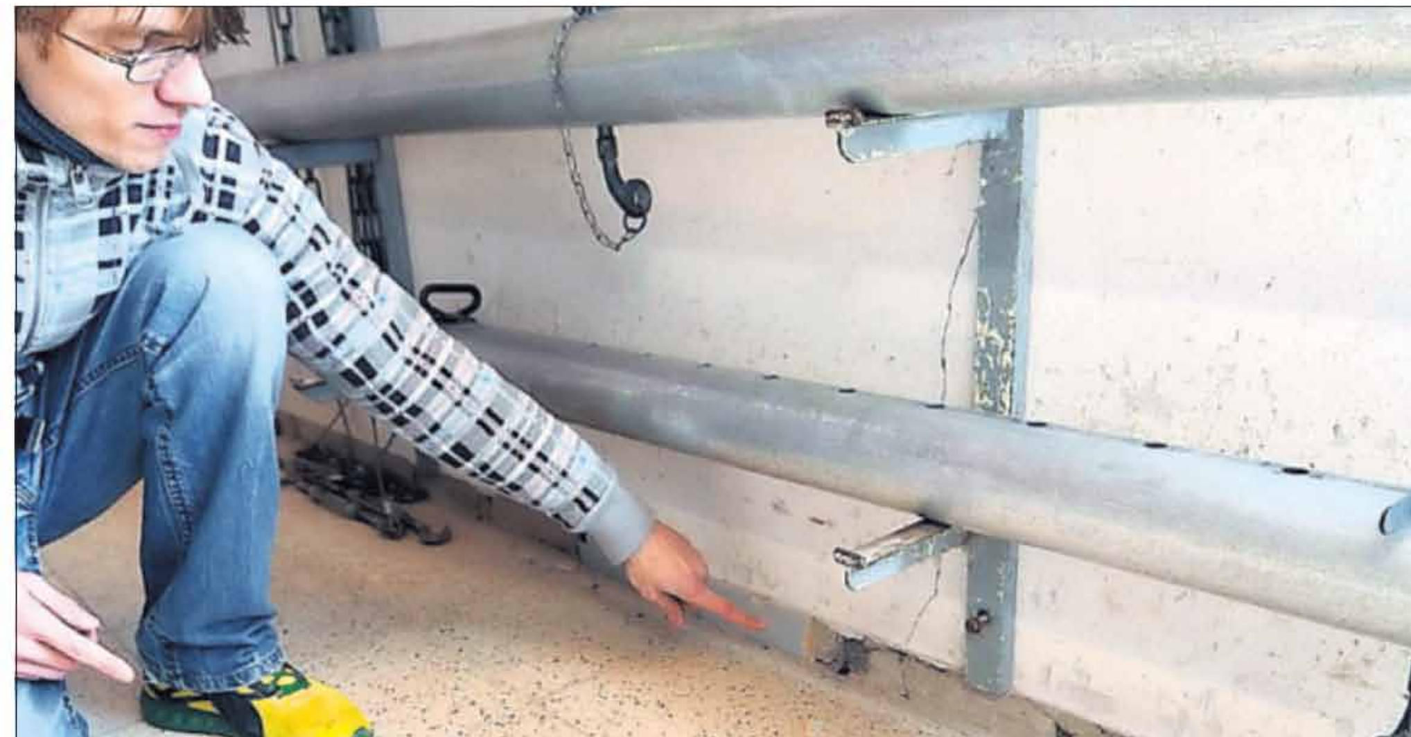
TV-Vorsitzender Dominik Ohmer zeigt im Geräteraum der Turnhalle Neuburg die Schadstellen.
